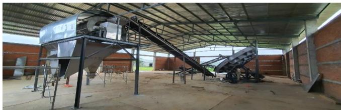
Hình 5. Nhà máy sau khi lắp đặt xong thiết bị
