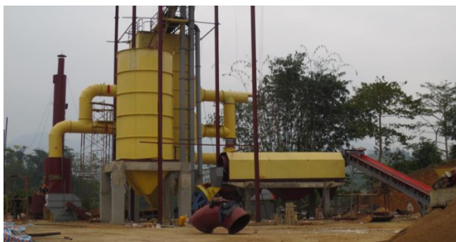
Hình 4. Toàn cảnh hệ thống thiết bị đã được lắp đặt trước khi đưa vào sử dụng chạy sản xuất
