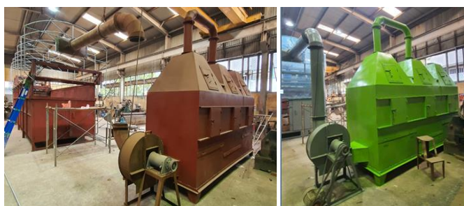
Hình 2. Hệ thống thiết bị lọc khí/khử mùi chế tạo, lắp ráp tại RIAM
