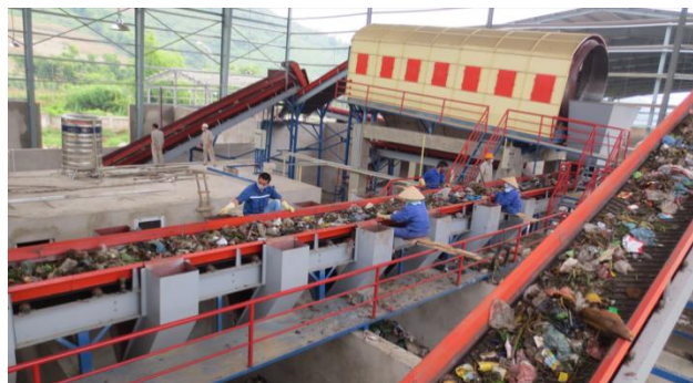
Hình 3. Hệ thống thiết bị Sàng phân loại - xé túi sơ cấp được lắp đặt tại nhà máy
