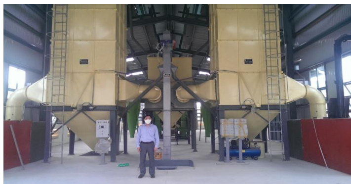
Hình 4. Hệ thống thiết bị khi đưa vào sử dụng chạy sản xuất
