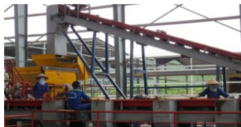
Hình 4. Thiết bị băm nghiền được lắp đặt tại nhà máy
